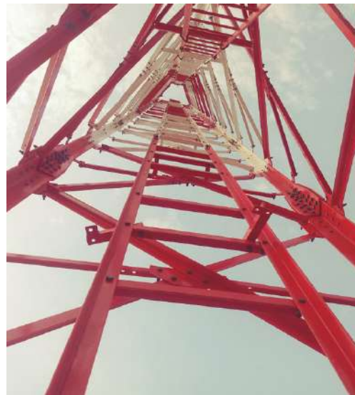
TORRE AUTOSOPORTADA DE H 30M BUJAMA BAJA CAÑETE
